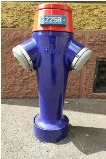
Abbildung 14: Blau-roter Oberflurhydrant in Dietlikon ZH
