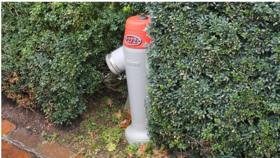
Abbildung 41: Beim Feldtest genutzter Hydrant, welcher durch eine Hecke teilweise verdeckt wird
