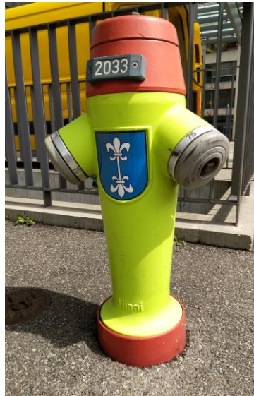
Abbildung 15: Gelb-roter Oberflurhydrant in Dietlikon ZH
