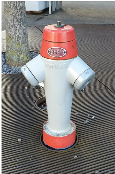
Abbildung 11: Zweiarmiger Oberflurhydrant in Altstetten Stadt Zürich
