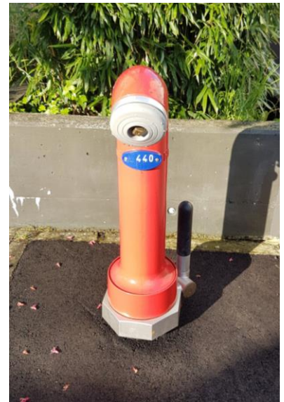
Abbildung 13: Einarmiger Oberflurhydrant beim Bahnhof in Thun BE
